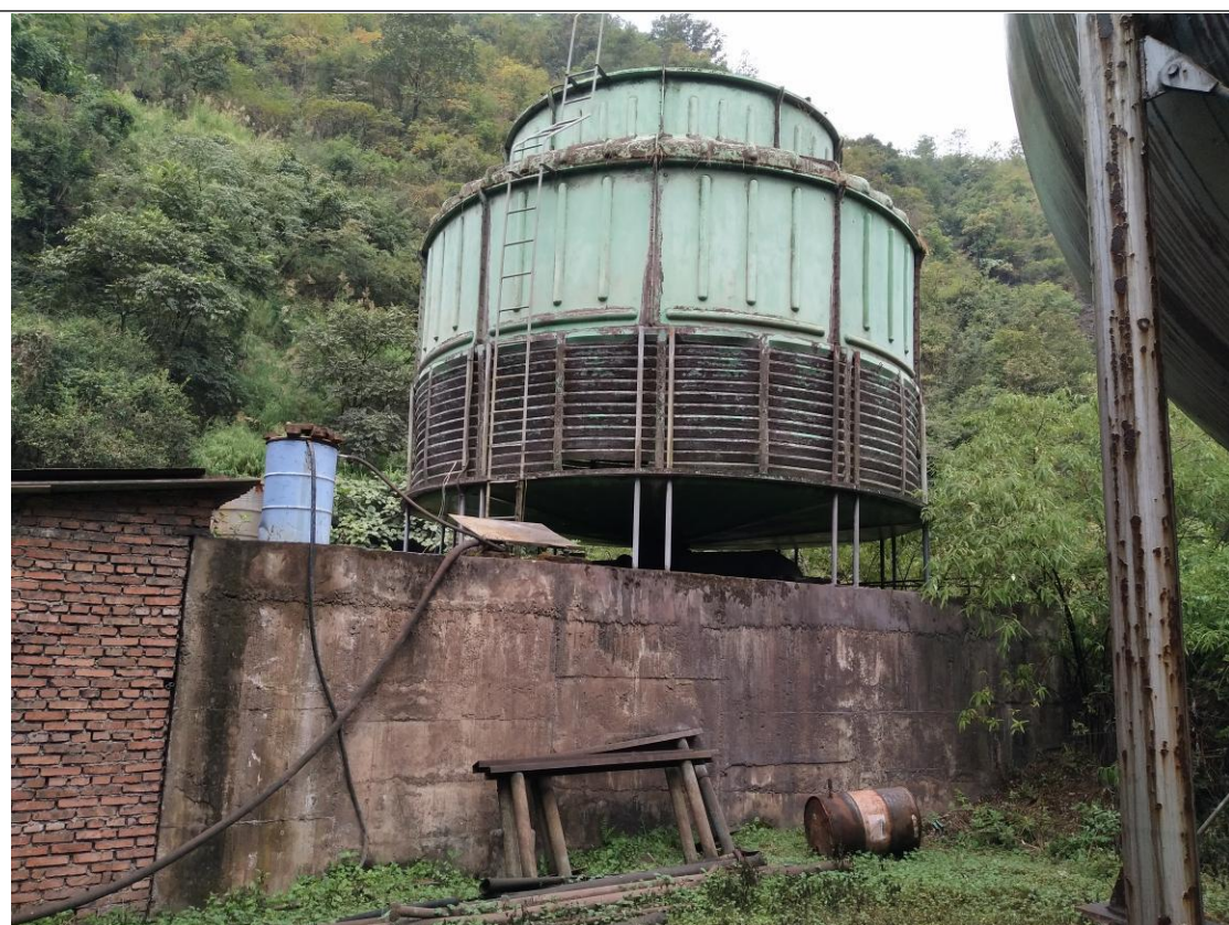
制氧站循环水池及冷却塔
