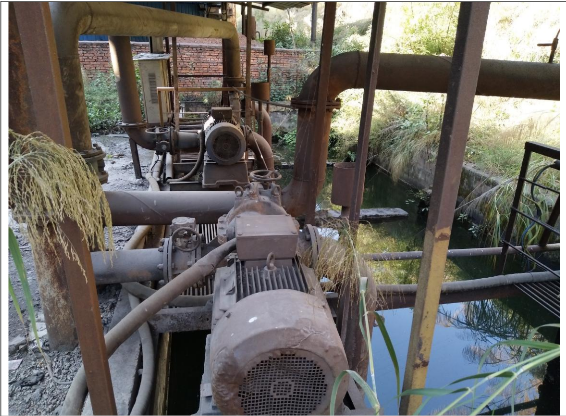
高炉冷却循环水池
