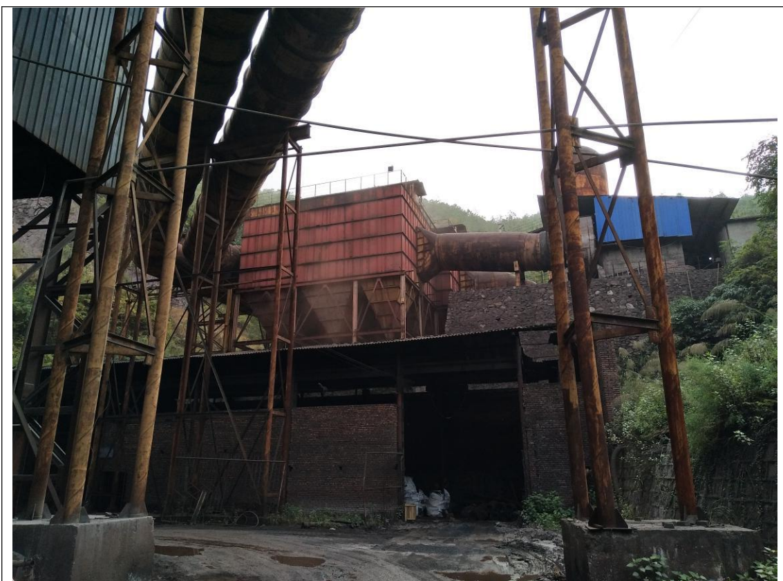
炼钢车间布袋除尘器及除尘灰暂存库
