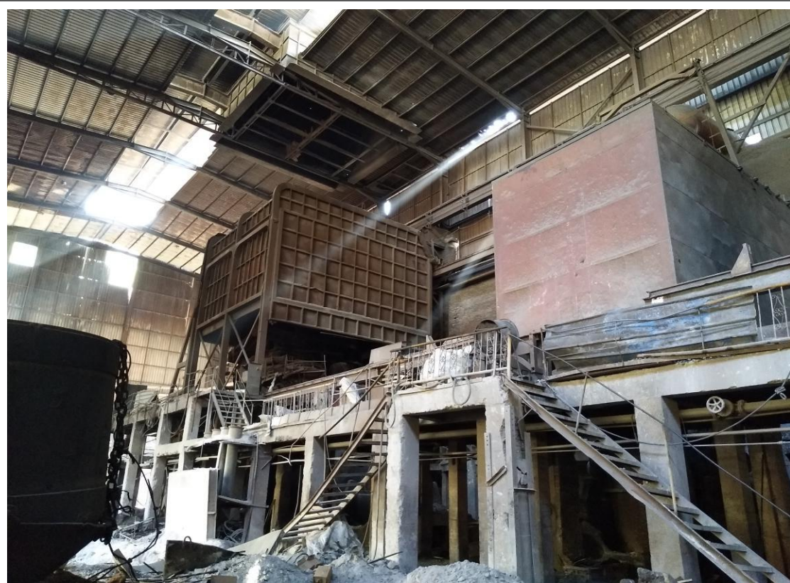
电弧炉、精炼炉积尘罩（内）
