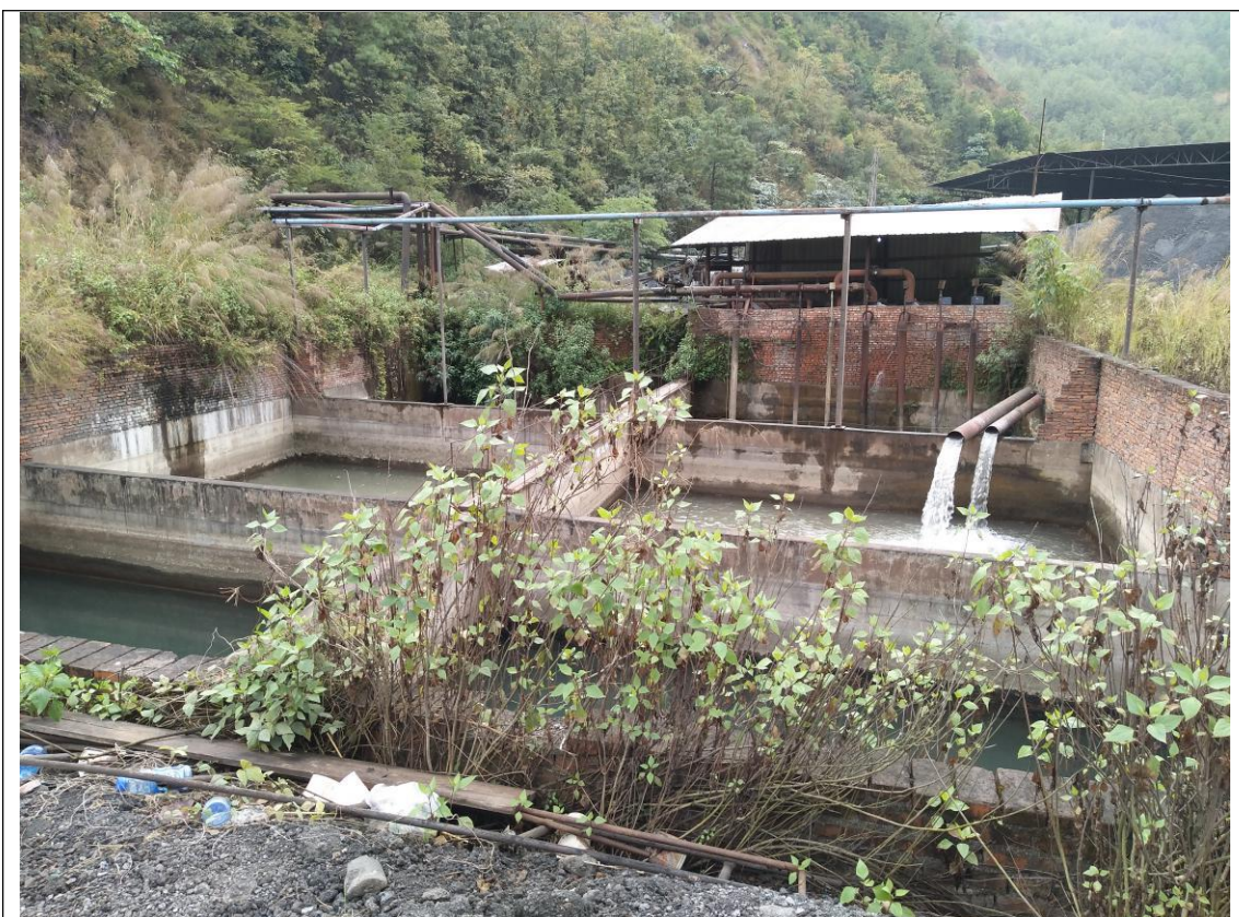
炼钢车间循环水池
