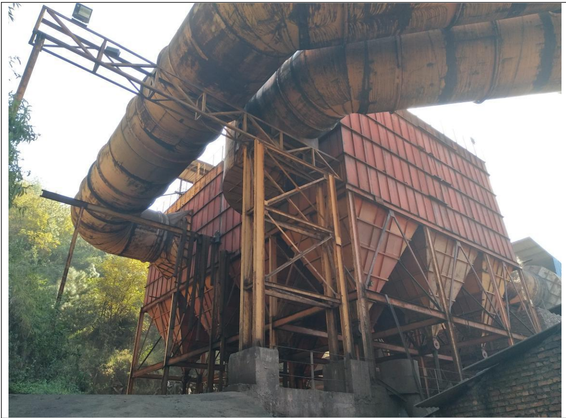
炼钢车间布袋除尘器
